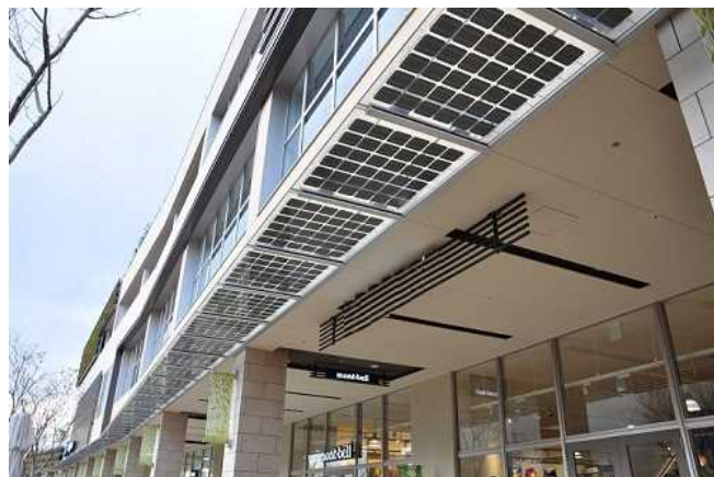
庇上に設置した薄型太陽光パネル（千葉県柏市）
